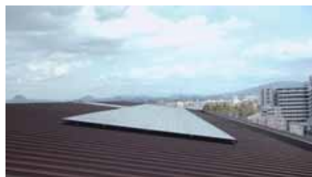
▲教室棟の屋上に設置されたソーラーパネル。他にもトイレなどの給水用に雨水循環システムを採用するなど環境に配慮。
