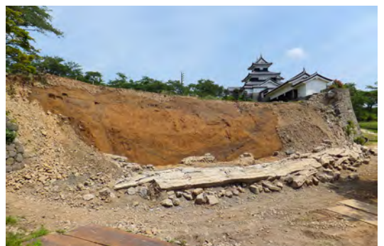
崩落石材撤去後の本丸南面
