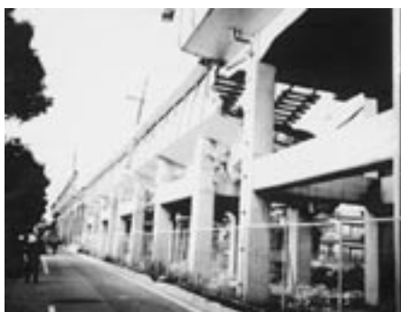
下食満高架橋 写真 1 (二層高架橋の上層部の崩壊)
