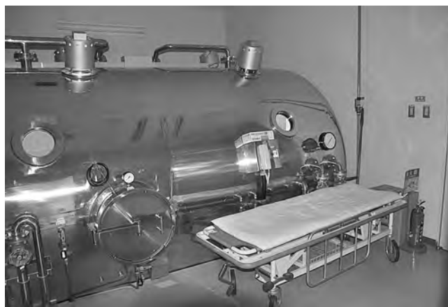
高気圧タンク
