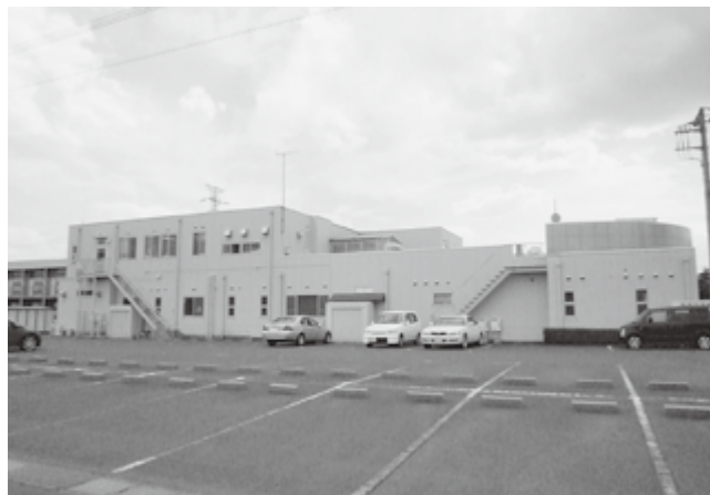
東日本大震災後の渡辺内科クリニックの全景： 細かいひび割れは見つかったが大きな損害はなかった。
