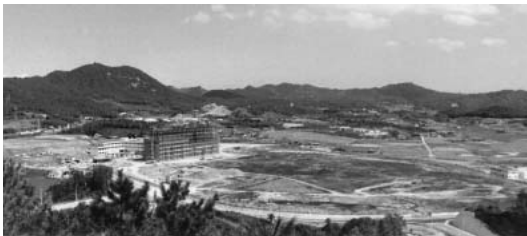
図1 基礎臨床研究棟の建設風景 建設中の基礎臨床研究棟の北側に一般教養棟を見ることができます。
