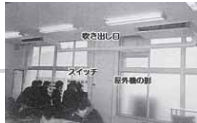
教室に設置されたエアコン
