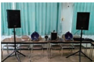
可搬型音響設備一式
